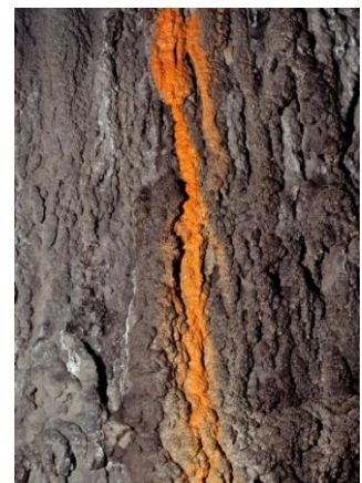
Starke Belastung durch Schwefel und Feuchtigkeit im Simplontunnel
